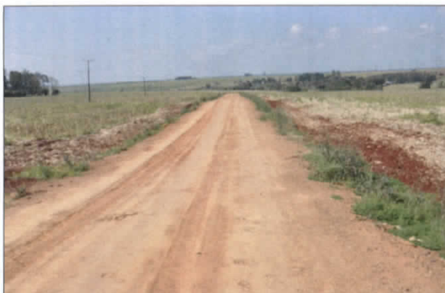
Áreas com problemas em dia de chuva
